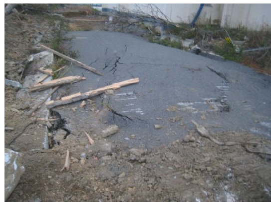
写真-16 第1野球場そばの建物際の舗装には液状化の痕跡がのこされている。
