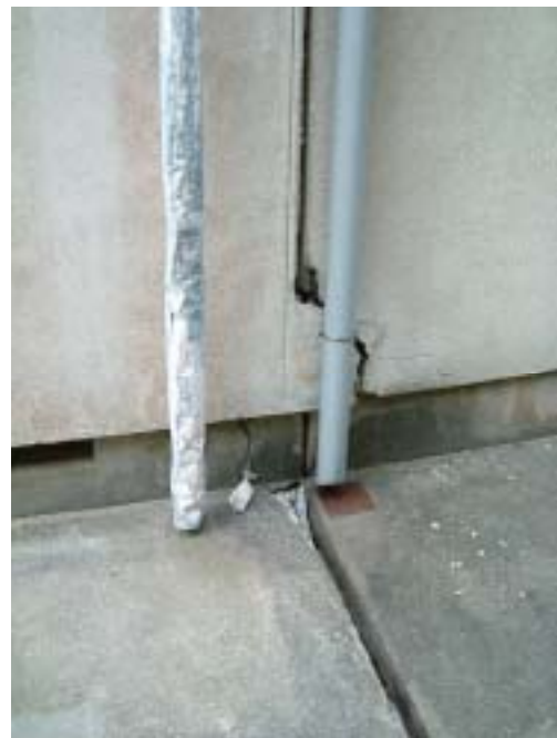
写真-11 玄海島小学校の反対側壁面の亀裂：以前に上からペイントで修復した跡が見られる。
