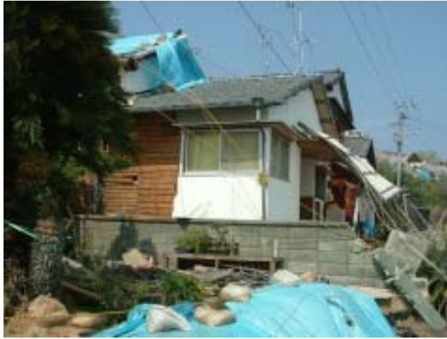
写真-14 右側のように壁が前に孕みだし、地盤が不同沈下して、モルタルが剥がれ全壊状態となった建物。
