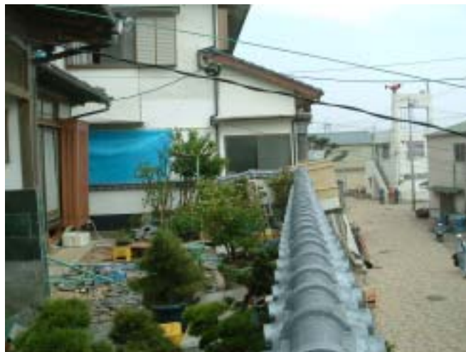
写真-16 石積みよう壁は無傷に見えるが、内部の盛土が沈下し、宅地がよう壁から離れるほど沈下し、建物が不動沈下により、大被害を受けた。
