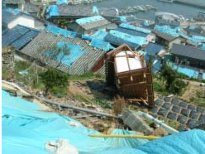
写真-12 手前側の土留め擁壁と宅地の崩壊により建物の上部構造が落下
